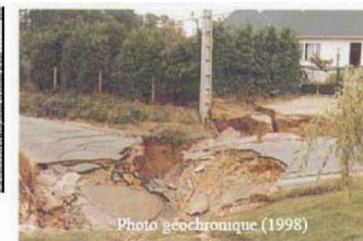
5 - Effondrement de carrière en Haute-Normandie
